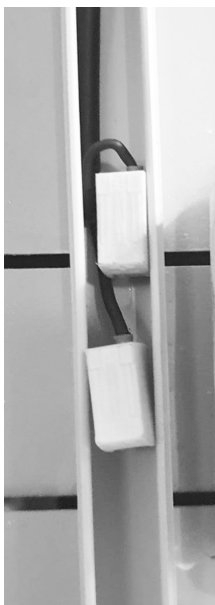
Připojení do kabelového kanálu
