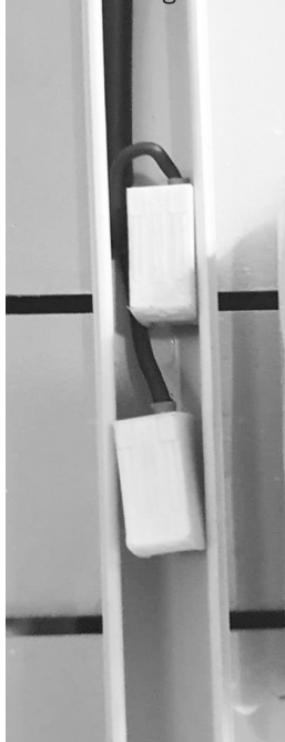
Anschluss in Kabelkanal
