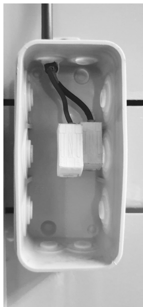
Collegamento in una scatola di derivazione
