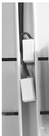
Aansluiting in kabelkanaal
