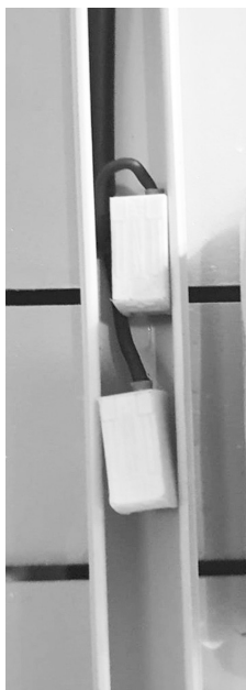
Collegamento nella canalina per cavi
